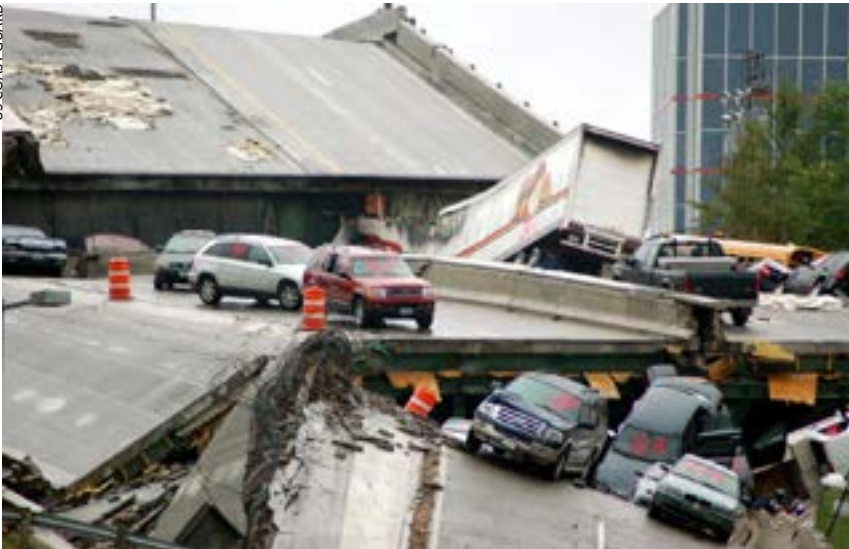
Effondrement, le 1 er août 2007, d'un pont autoroutier datant de 1967, sur le Mississippi, à Minneapolis.
