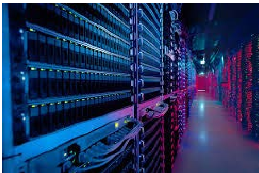
Des serveurs dans un data center, brassant d'énormes quantités de données.
